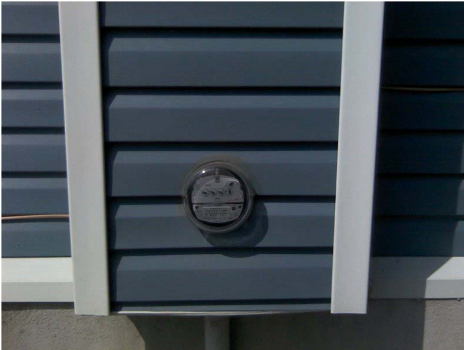
Compteur encastré dans le revêtement d'une maison
