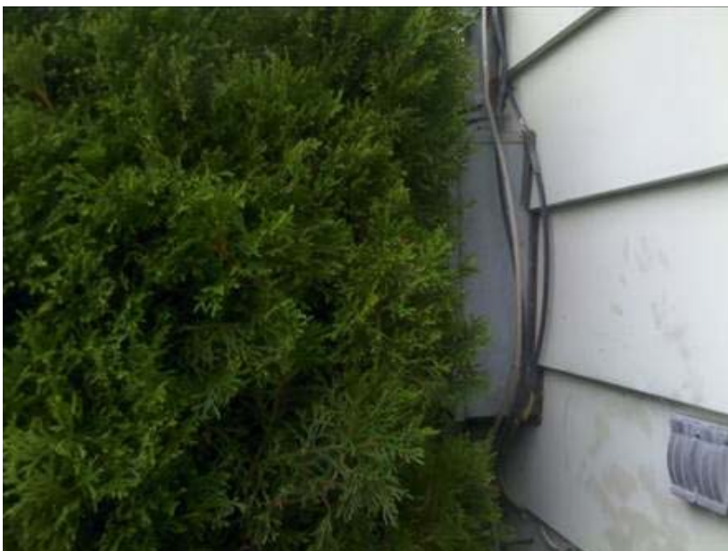
Arbuste qui empêche l'accès au compteur
