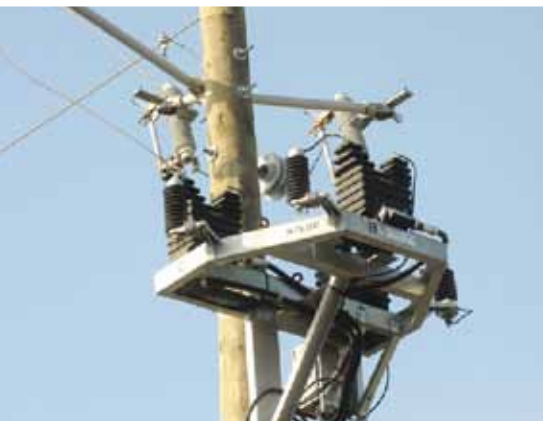
Transformateurs de Tension Télésignalés (TTT)
