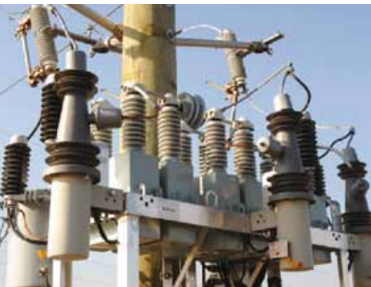
Batteries de Condensateurs (BC)
