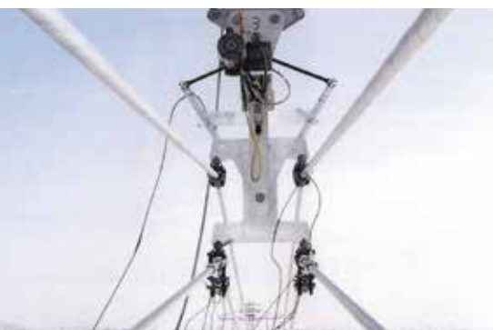
Capteurs de déplacement relatif sur un faisceau de quatre conducteurs
