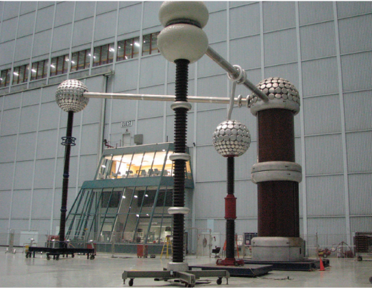
Vaste hall de 82 m de long x 67 m de large x 50 m de haut. Cette aire d'essais est isolée contre les perturbations radioélectriques (atténuation de 50 à 60 dB à 1 MHz et atténuation acoustique).
