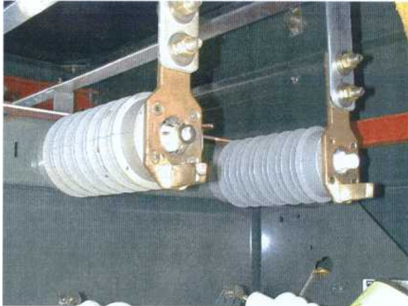
Le résultat de l'incident est démontré sur la photo #2 .
