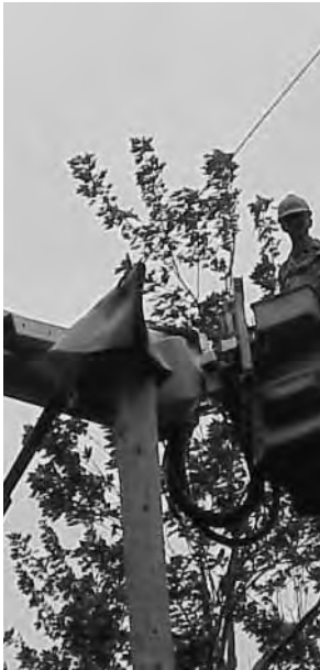
Nacelle au-dessus d'une ligne monophasée bien protégée
