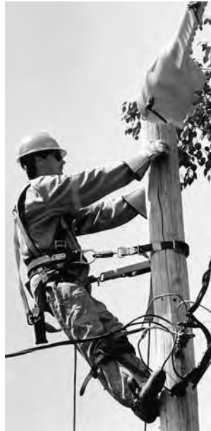
Monteur positionné en dessous d'une ligne monophasée bien protégée
