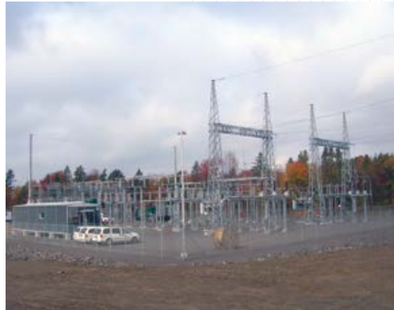
Exemple de poste à 120-25 kV (poste de Neubois).
