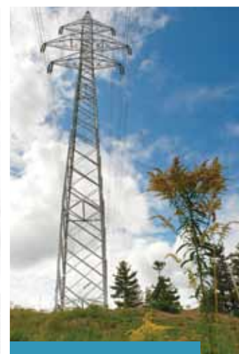
Pour la ligne Chénier-Outaouais, on a conçu un nouveau type de pylône à 315 kV qui utilise moins d'espace au sol. Une innovation qui a permis de diminuer l'engorgement sur les terres agricoles.
