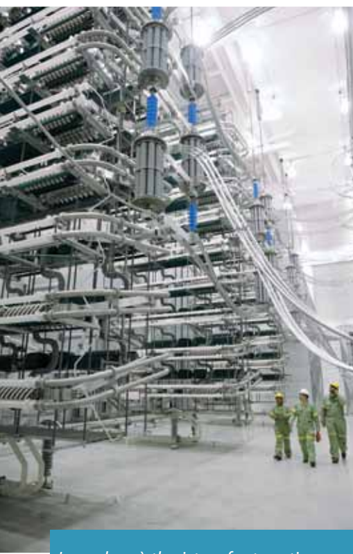
Les valves à thyristors font partie du groupe convertisseur. Elles constituent le cœur de la conversion qui permet de séparer le réseau du Québec de celui de l'Ontario.
