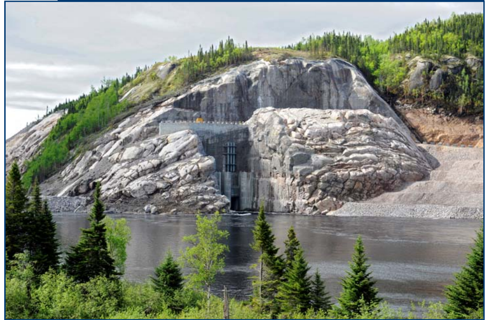
Chantier de la Romaine-2 – Portail amont de la galerie de dérivation provisoire
