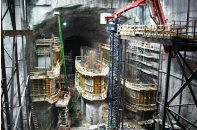
Chantier de la centrale de la Romaine-2 (640 MW), la plus puissante du complexe et la première qui sera mise en service, en 2014.
