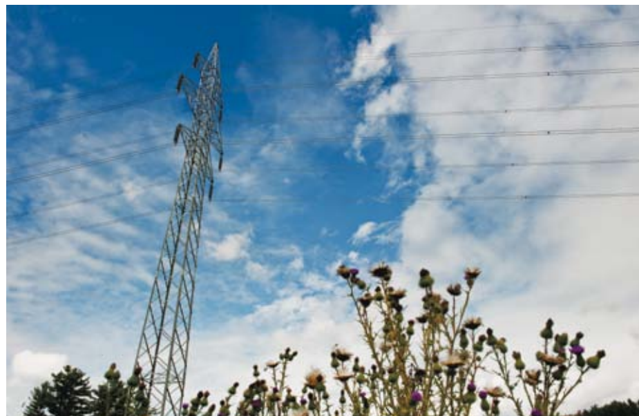
▼ Pour réduire l'impact de la ligne Chénier–Outaouais en milieu agricole, on a conçu un nouveau type de pylône à encombrement réduit.
