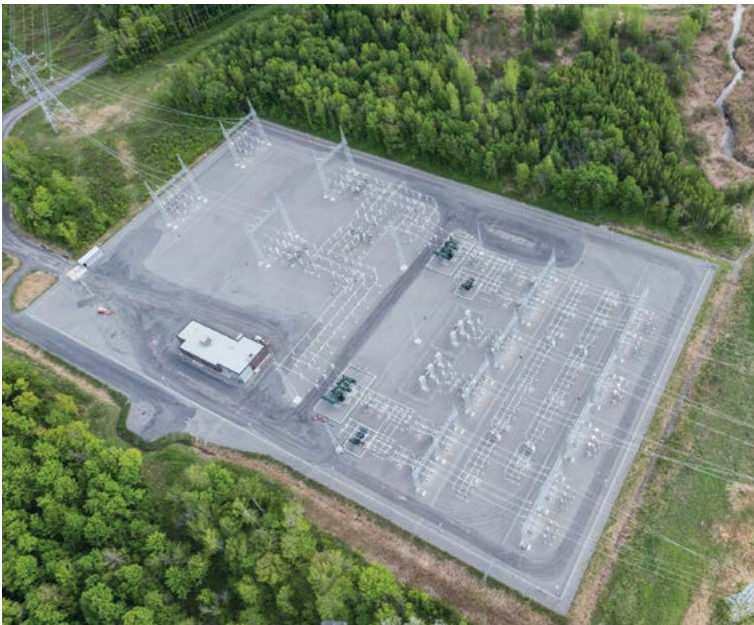
Poste Pierre-Le Gardeur à 315-120 kV, semblable au poste d'Argenteuil projeté
