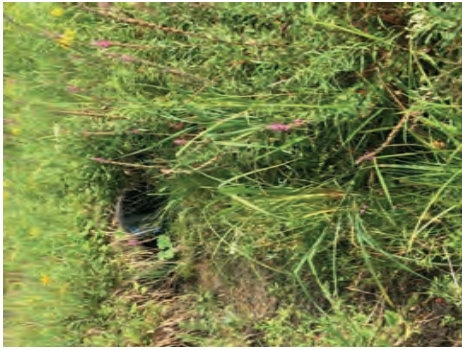
Photo 20 Cours d'eau CE03, ponceau
