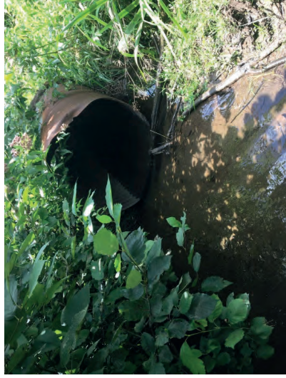
Photo 27 Cours d'eau CE06, ponceau
