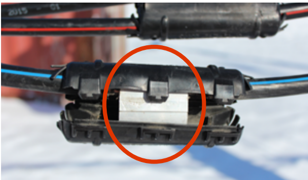
Protecteur ouvert ou endommagé
