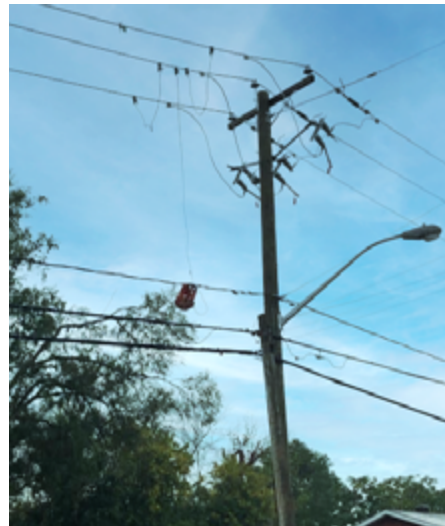
Mise à la terre d'une ligne moyenne tension pour en mettre une partie hors tension
