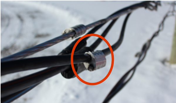
Protecteur manquant sur la connexion
