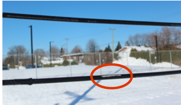
Gaine de conducteur endommagée
