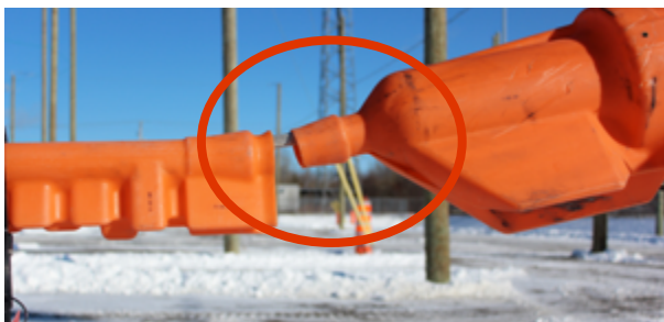
Partie de conducteur mise à nu à cause du mauvais emboîtement des protecteurs
